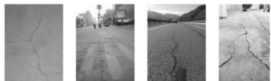
图 1 道路裂缝样例
